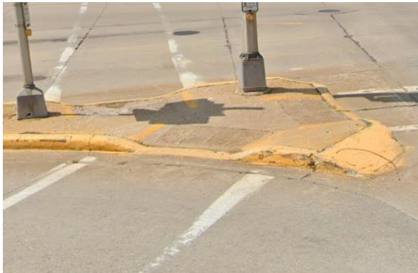
Rampa de bordillo que no cumple
