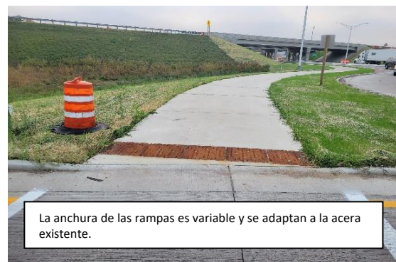
Rampa de bordillo que cumple
