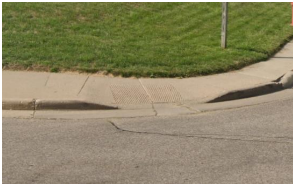
Rampa de bordillo que no cumple
